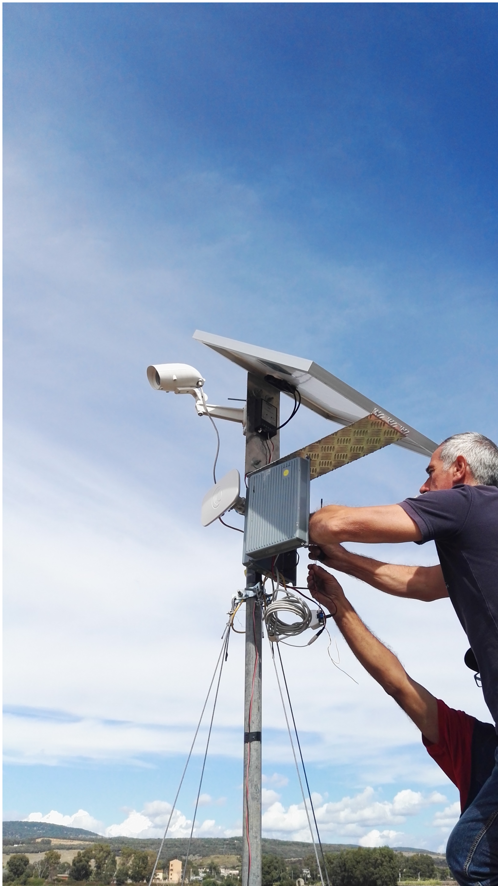
Fig. 16 Particolare della stazione autoalimentata presso Crustumerium.
